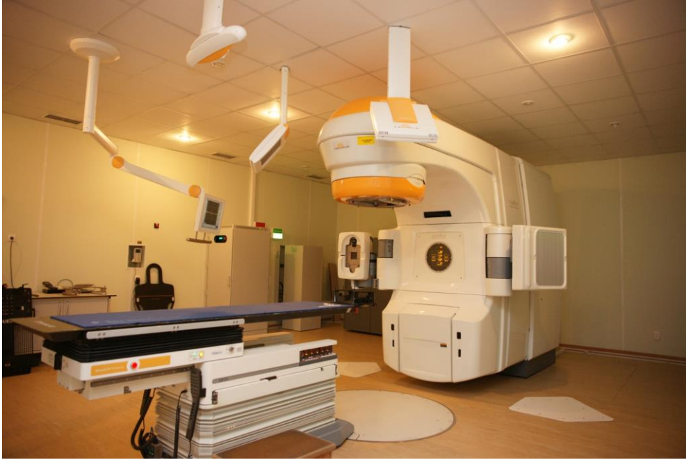
Рисунок 15 – Оборудованное помещение для проведения лучевой терапии
